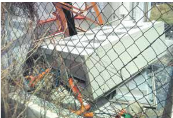
Après le passage d'Irma
