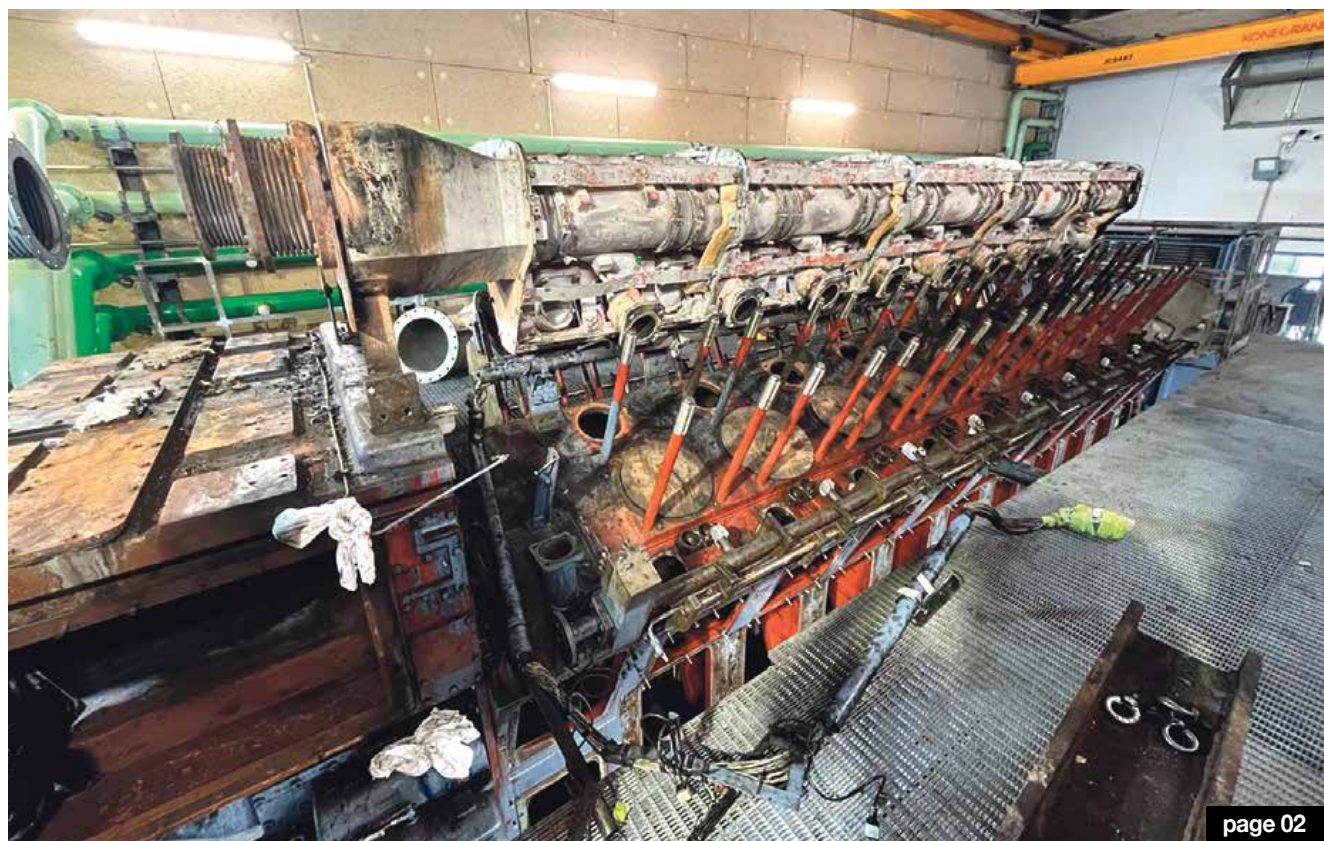
Moteur de la tranche 3 en cours de réparation.
