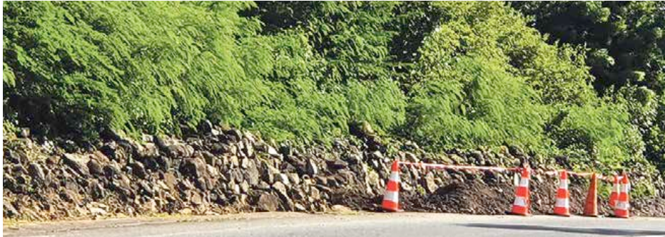
Avec les travaux, les murets de pierres sèches ont été déconstruits, pour enfouir les réseaux électriques qui permettront de procéder à l'éclairage public de la route de Bellevue.
