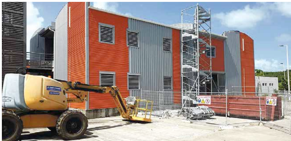
La Collectivité informait en ce milieu de semaine que les travaux d'étanchéité de la toiture des classes mobiles étaient achevés. Hier, jeudi 2 novembre, des engins de travaux publics étaient encore présents sur site.
